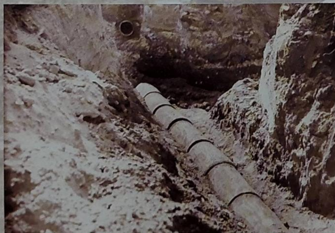
Ерте дәуір су құбыры Древняя водопроводная система Ancient water pipe system
